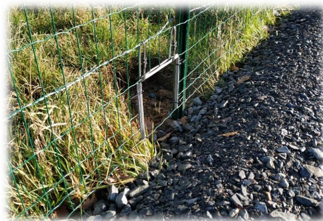
Exemple de passage à faune – CERMECO
